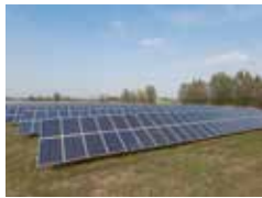
CAMPO FOTOVOLTAICO SOLAR FIELD
